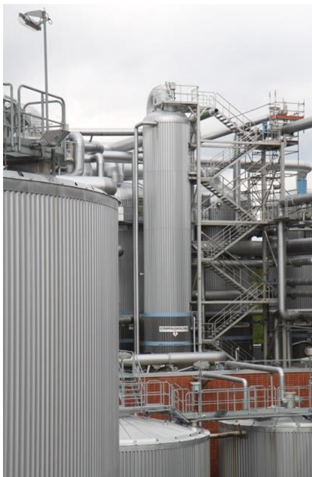
Figura 44: Separación de metanol de la planta de celulosa: tanques de almacenamiento y sistema de extracción de condensado sucio (KnowPulp, 2019)
