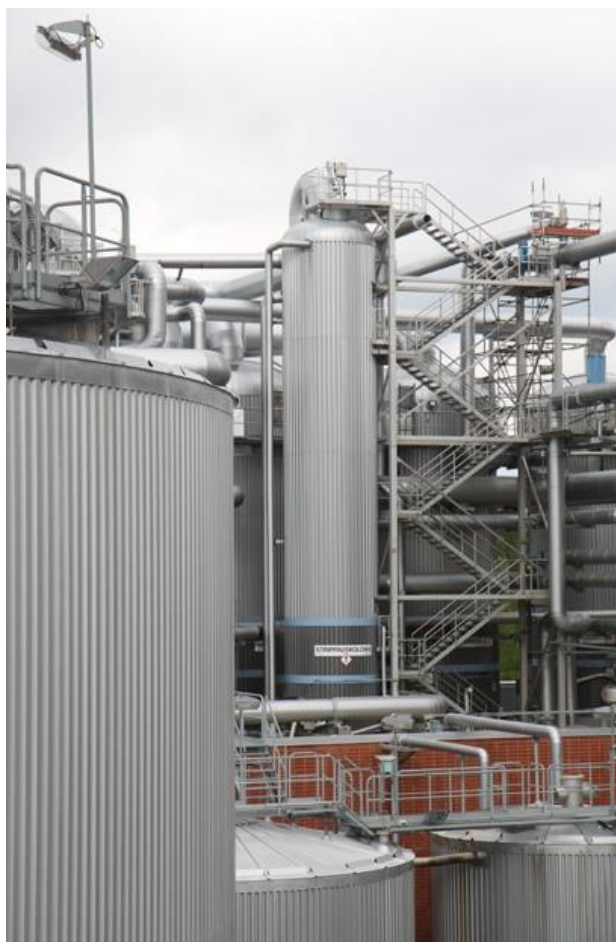
Εικόνα 44: Διαχωρισμός μεθανόλης από βιομηχανία χαρτοπολτού: δεξαμενές αποθήκευσης και σύστημα αφαίρεσης ακάθαρτων συμπυκνωμάτων (KnowPulp, 2019)
