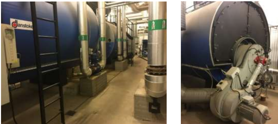
Figur 2: De två oljepannorna för reserv och spetslast (Energikontor Sydost).
